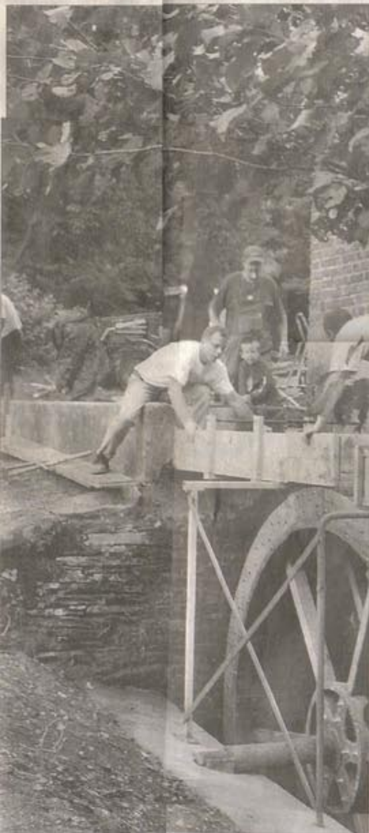
Nach dem Einbau des neuen Rades musste noch der Zulauf auf das Rad reguliert werden.
